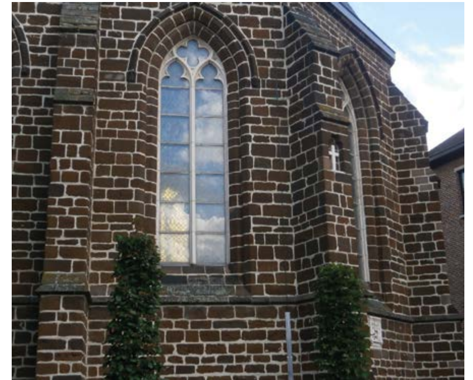
Beeld na het verwijderen van de zwaarst beschadigde diestiaanblokken van de Sint-Catharinakerk in het begijnhof van Diest
